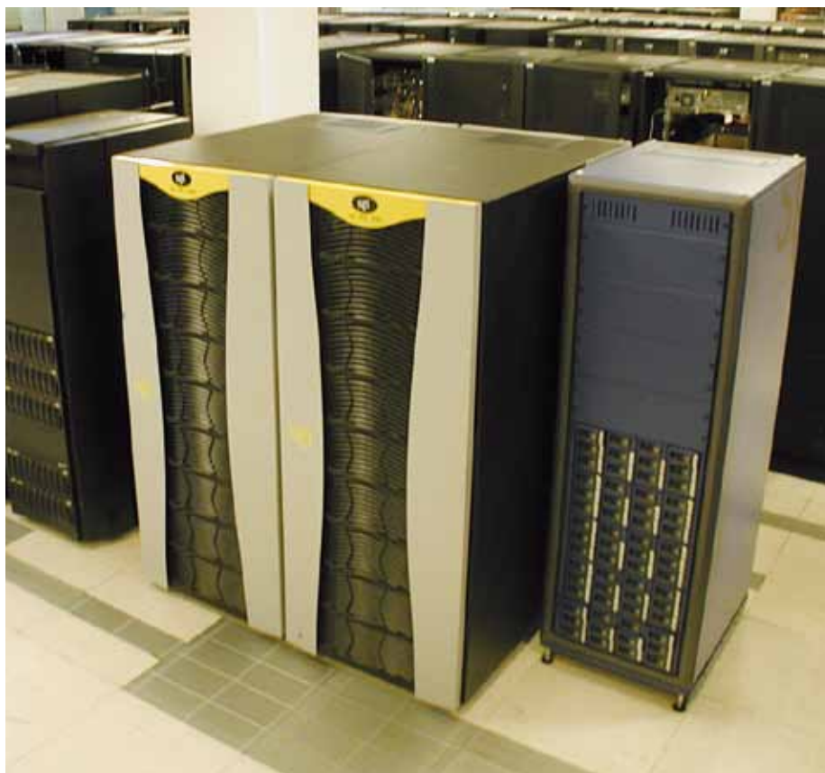
Sala macchine CINECA
